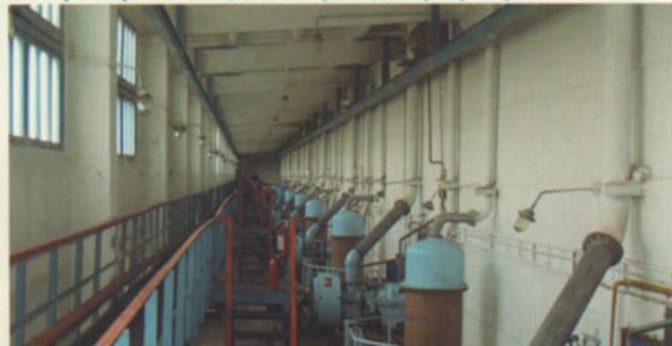
Компрессорная станция газопровода «Бухара-Урал»
